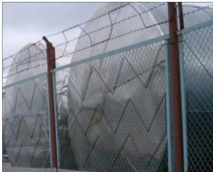
Фото 2. Сенсорный кабель, смонтированный на охраняемый периметр
